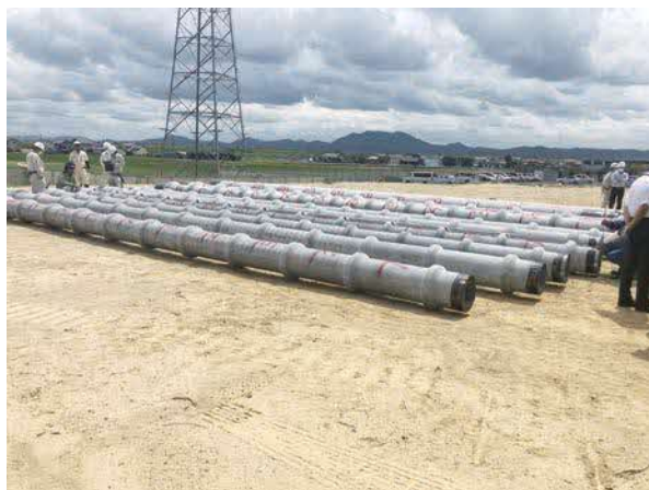
■新体育館で実際に使った杭です。杭は工場からトラックで運ぶために分割してあるので、現地でも右写真の部品を使い繋いで使います。
