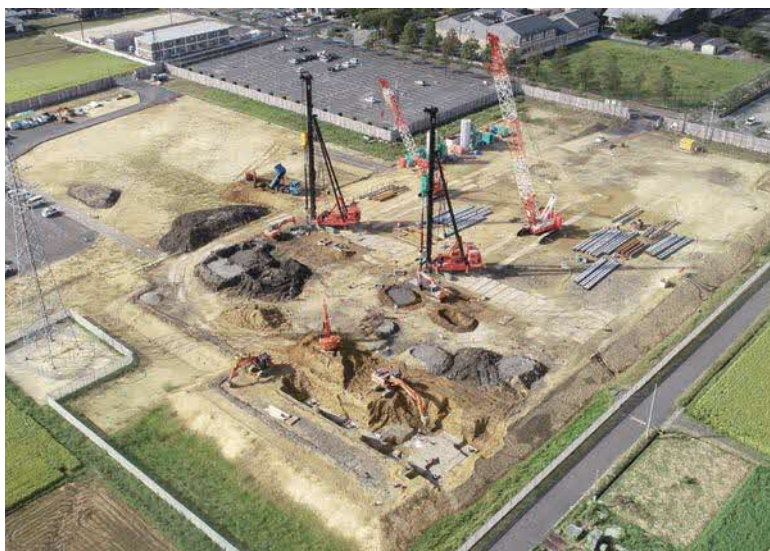
■杭工事の様子です。敷地左側に積んである黒っぽい土は、杭を入れる穴を掘った時に出土で、黒っぽく見えるのはセメントミルクを混ぜたためです。
