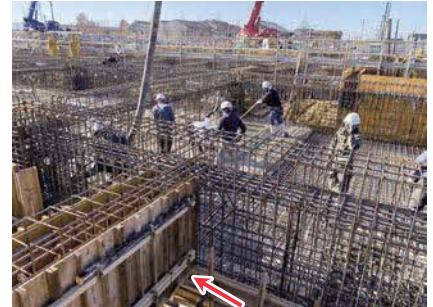
④・⑤鉄筋組立の様子。手前矢印部分が型枠設置済の部分です。
