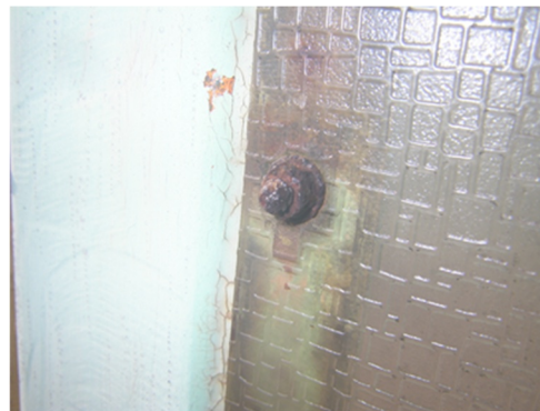
腐食（取付ボルト）
