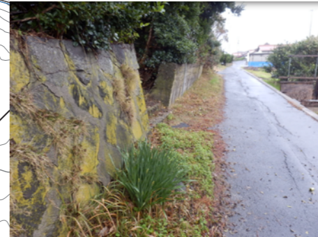
避難道路危険箇所
