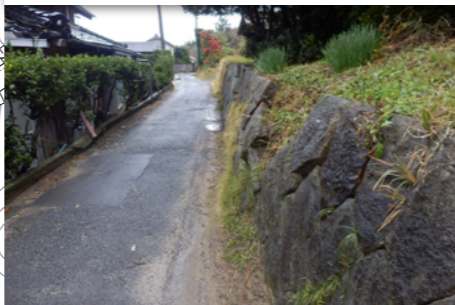
避難道路危険箇所
