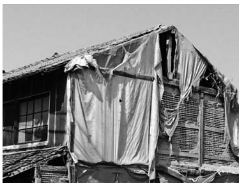
危険な状態で放置されている空き家
