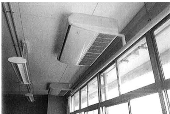
中学校に設置されたエアコン
