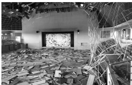
熊本地震により天井が崩落した避難所
