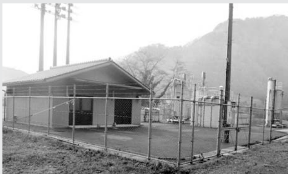
出雲市水道事業に統合される簡易水道施設 (須佐簡易水道の淀原水源池)
