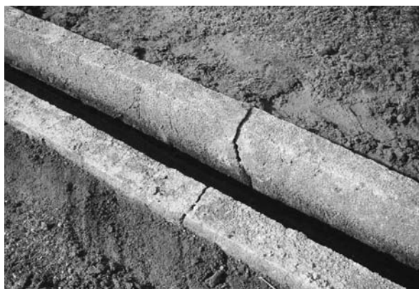
修繕が必要な用水路
