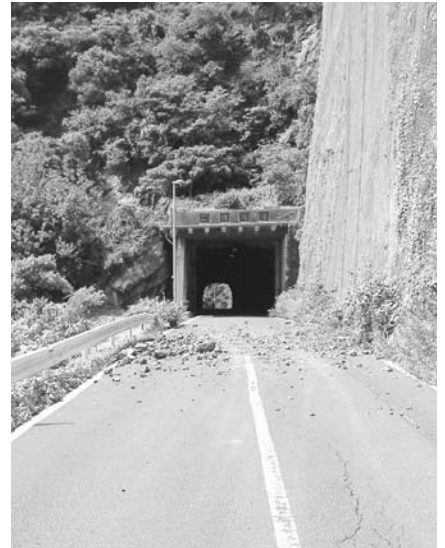
土砂崩れの状況（県道大社日御碕線）
