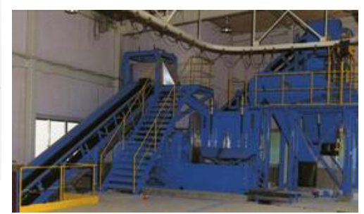
・機械設備全景
