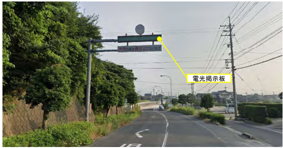
各設備の設置状況(南側)
