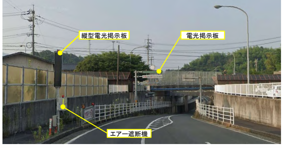
各設備の設置状況(北側)
