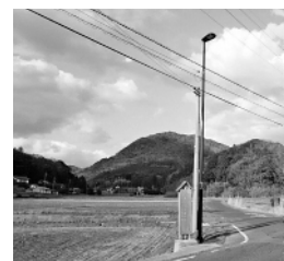
LED照明に更新後の照明灯(多久町地内)
