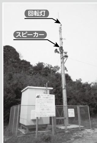
放流警報局 (大津町上米原地内)
