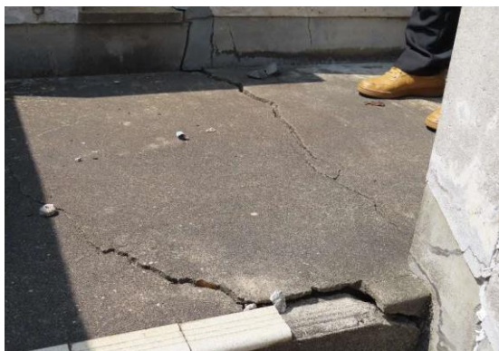
床スラブのひび割れ
