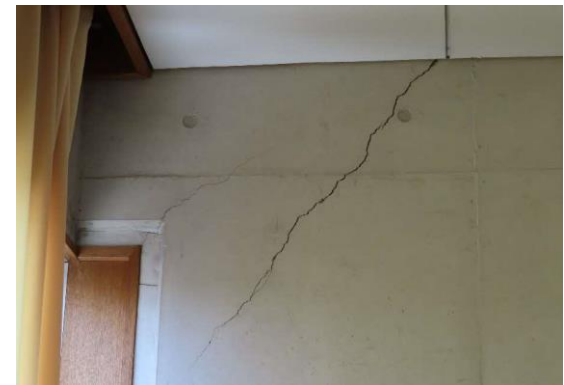
内壁のひび割れ
