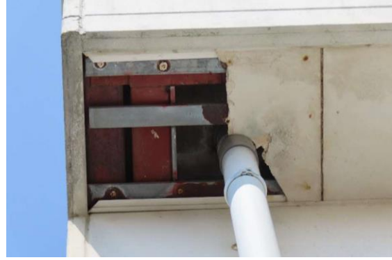
雨水による軒天の破損
