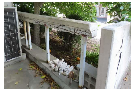
手摺の露筋を伴う爆裂、ひび割れ
