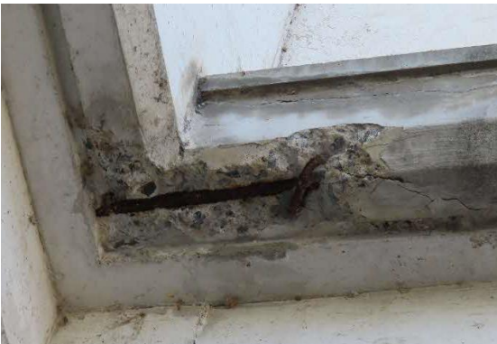
軒先の鉄筋の露出
