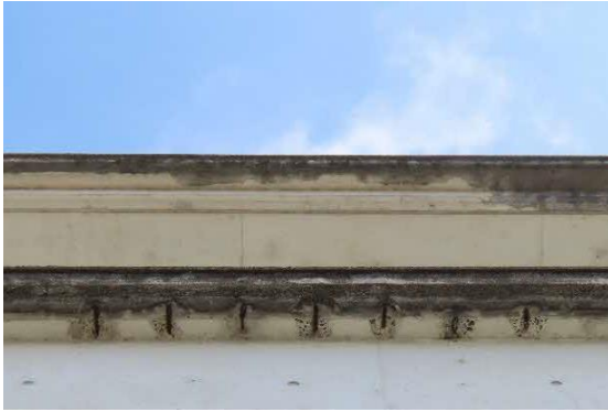
軒裏の露筋を伴う爆裂
