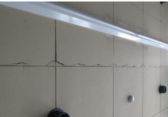
天井材のひび割れ
