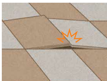
床タイルの浮き
