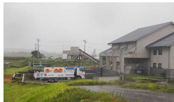
排水ポンプ車 (出雲河川事務所 保有) R6.8.30 台風10号 新内藤川排水機場での待機状況
