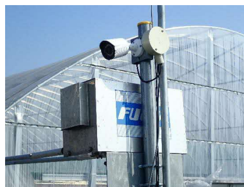
防犯カメラの設置
