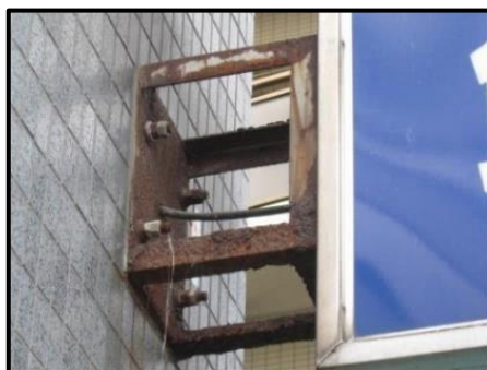
サビによるブラケットの腐食
