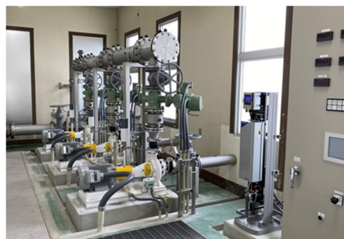
👉 更新した浜ポンプ場
