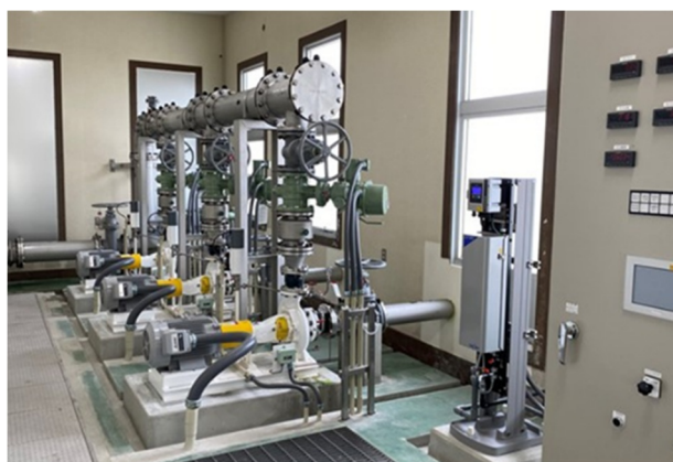
浜ポンプ場送水施設
