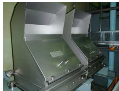
＜水素処理装置（18台）＞
