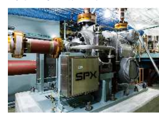
＜高圧原子炉代替注水ポンプ＞
