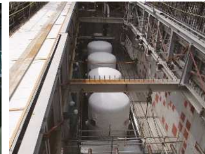
＜フィルタ付ベント設備＞
