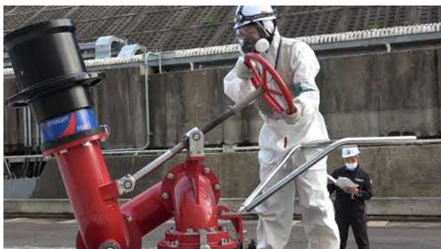
放水砲による放水準備
