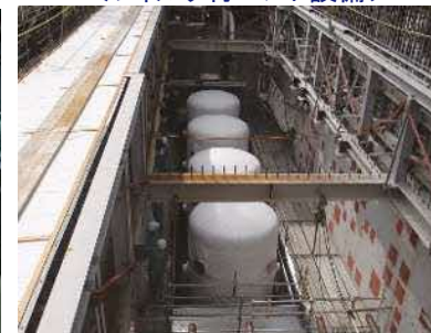
<フィルタ付ベント設備>
