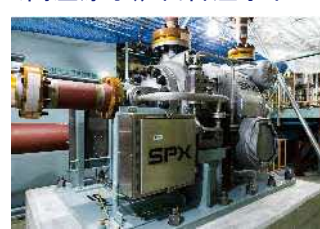
<高圧原子炉代替注水ポンプ>
