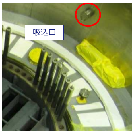
対策①：吸込口閉止（溶接構造）
