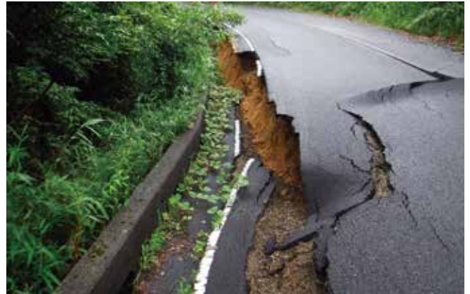
▲妙見一畑山線の道路崩落(小境町)
