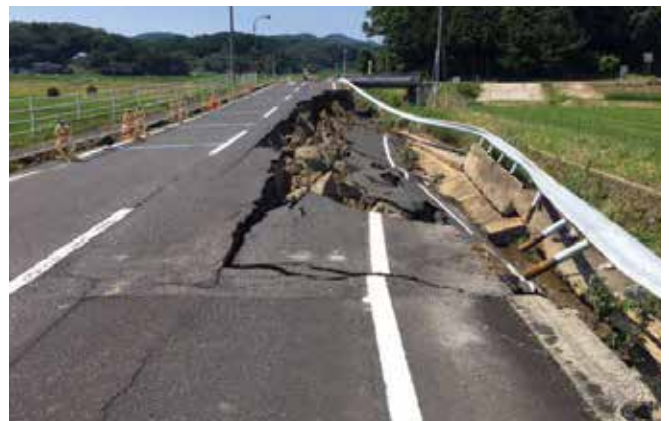
▲伊野本線の路肩崩壊(美野町)
