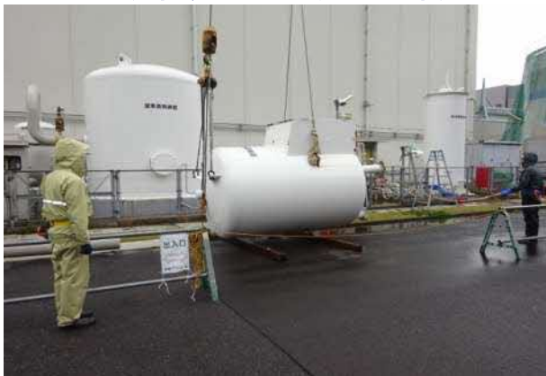
放射線管理区域外にある役目を終えた設備の解体撤去 (窒素ガス制御系設備の撤去【完了】)
