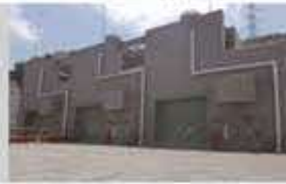
ガスタービン発電機
