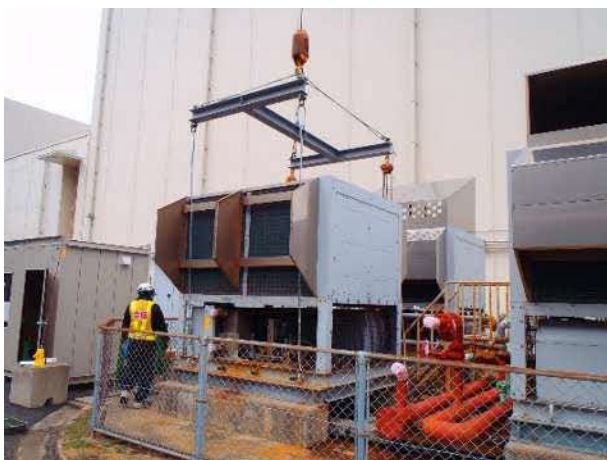
放射線管理区域外にある役目を終えた設備の解体撤去 (原子炉建物空気冷却系冷凍機の撤去【完了】)
