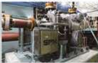
高圧原子炉代替注水ポンプ
