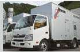
高圧発電機車
