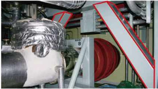
耐震補強工事を実施した配管
