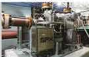
高圧原子炉代替注水ポンプ
