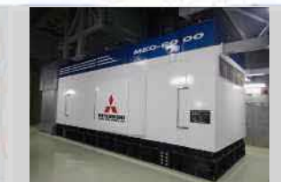
ガスタービン発電機
