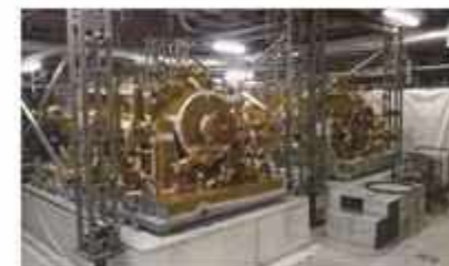
残留熱代替除去ポンプ
