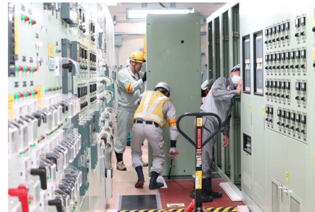
管理区域外にある役目を終えた設備の解体撤去 (中央制御室制御盤の撤去)
