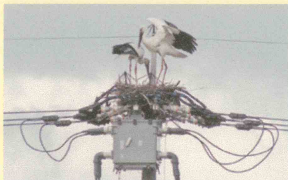
電柱に造巣するコウノトリ
