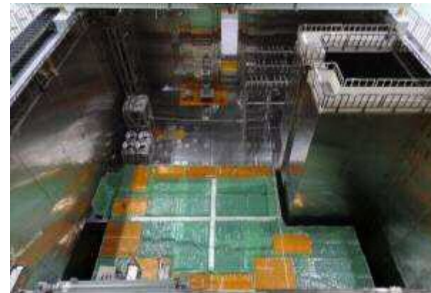
受取検査後、燃料プール他に保管
