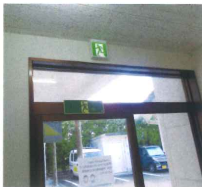
避難口誘導灯
