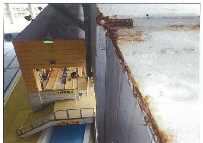
ダクトの腐食状況
