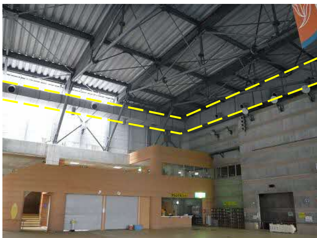
――で囲った部分が空調ダクト
