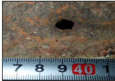
【中央制御室非常用再循環系ダクトの腐食孔】 4箇所の腐食孔 ※直径約8mm〔最大〕
