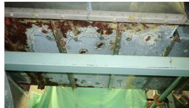
3箇所の腐食の一例
