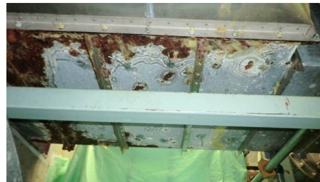
3箇所の腐食の一例
