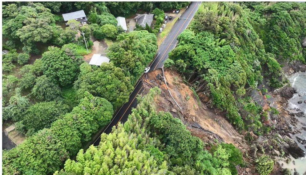
県道大社日御碕線の崩落(大社町日御碕):島根ドローンサービスセンター提供写真)
