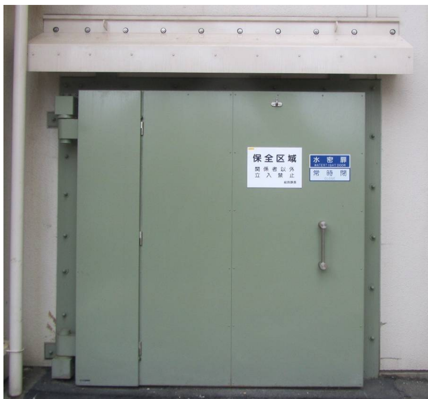
▲2号機建物外壁に設置した水密扉
