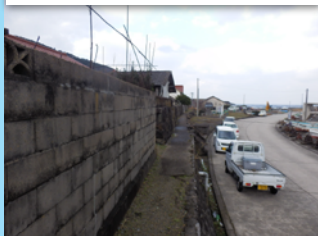
危険箇所 ブロック塀
