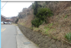
危険箇所 崖・石垣
