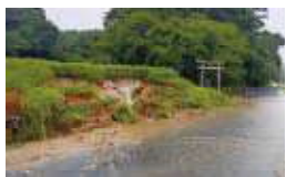
▲「8月10日畦畔崩落」
