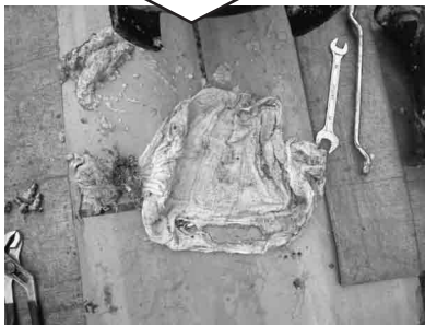
マンホールからポンプを引き上げ、詰まっていたタオルを取り出しました。
