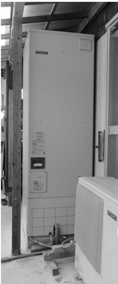
破損が続くエコキュート（温水器）
