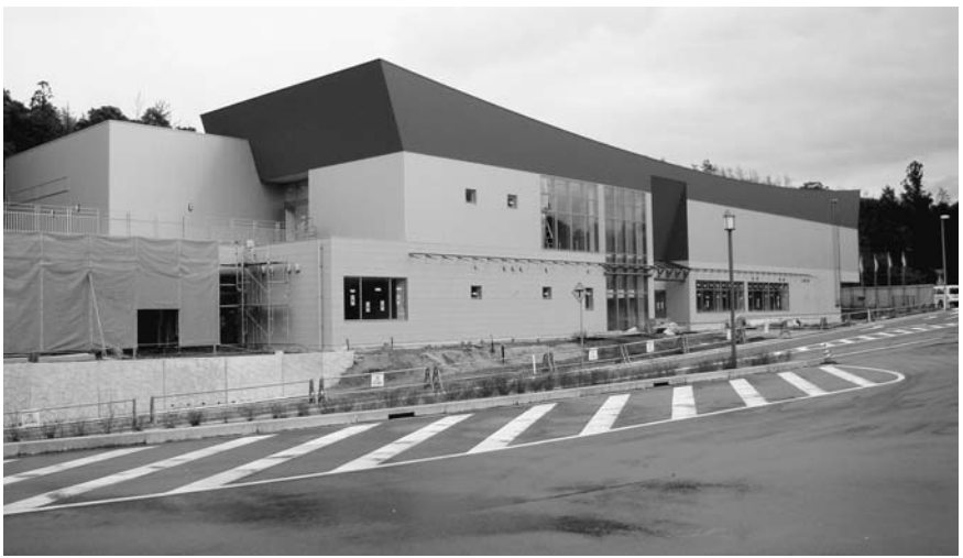
国指定史跡西谷墳墓群をはじめとする市内遺跡を紹介するガイダンス施設と、市内遺跡の調査・研究拠点となる埋蔵文化財センターの機能を併せ持つ施設として建設を進めている「出雲弥生の森博物館」。ガイダンス施設としての博物館は平成22年春の供用開始を予定し、平成21年5月の建築工事後、埋蔵文化財センターとしての業務を開始します。それに先立ち、施設の設置及び管理に関する条例を定めました(2月25日撮影)
